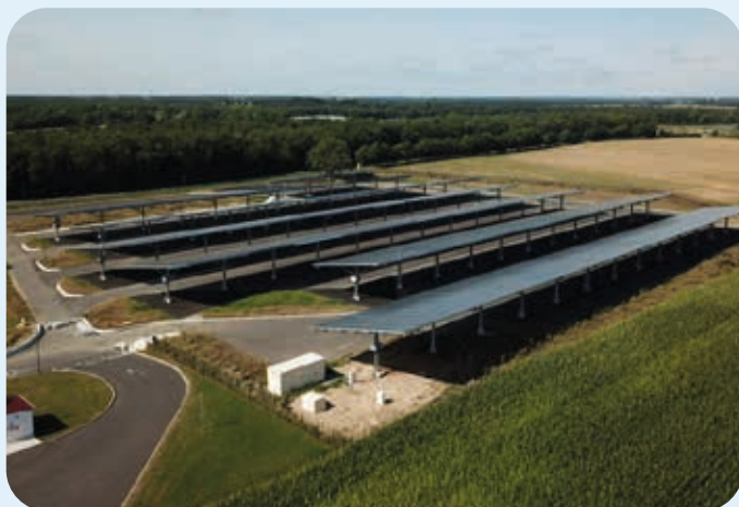
SORIGNY 1 - 2 409 kWc Mise en service le 28 avril 2021
