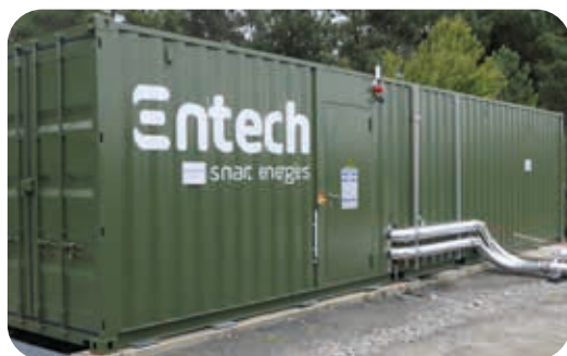
Stockage d'énergie de grande puissance (2,5 MW) couplée à la centrale photovoltaïque au sol.
